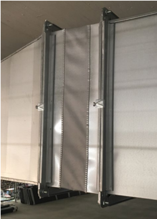
Bild 9.2 Eingebauter Weichstoffkompensator zwischen den Kanälen
